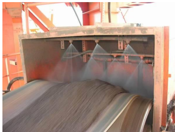
装卸机械上的喷淋系统
